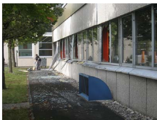
Aussenfassade Fa. Hänggi nach Explosion
